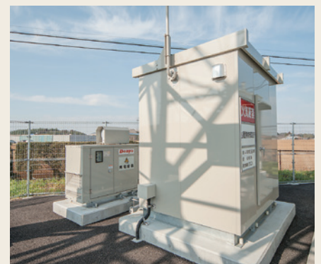
■ 非常用発動発電機・油庫
