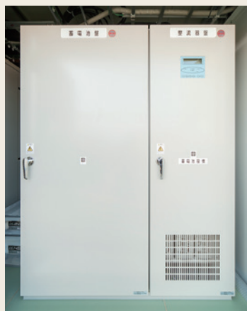
■ 直流電源装置
