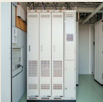
■ 基地局無線装置
